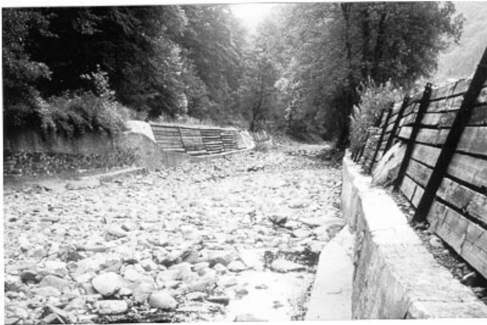
Foto 19: Wasserableitungen an der Sieber (unterhalb der Ortschaft Sieber) führen zur Artenverarmung und zu Grundwasserabsenkungen in der Weichholzaue.
